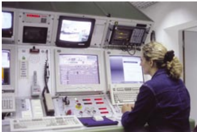
Rys.31 Pulpit kontrolny w pomieszczeniu sterowni systemu terapii.
